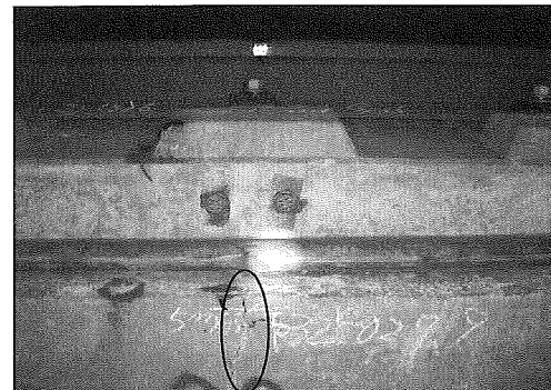
写真-2 中央通路側壁部のひび割れ
