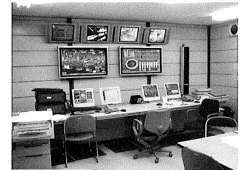
写真-1 シールド掘進管理システム
