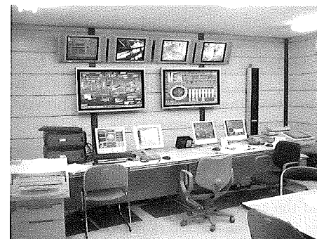
写真はシールド掘進管理システム
