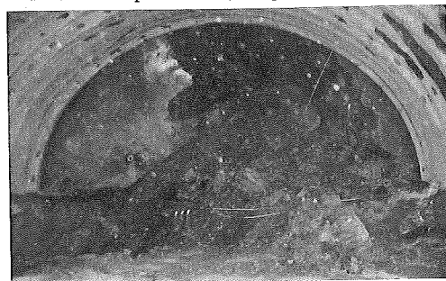
写真は切羽崩壊状況
