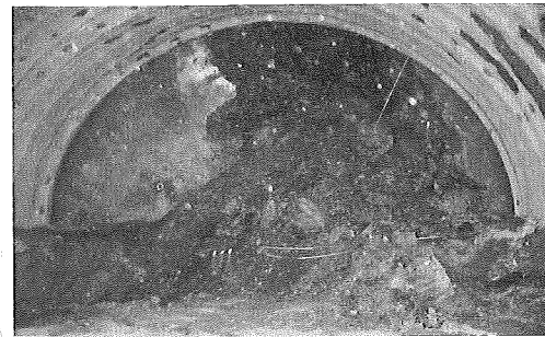
写真-1 切羽崩壊状況(TD=706m)
