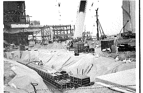
▲ 川越火力発電所 (中部電力株)
