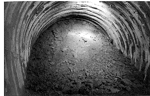
写真は上倉工区崩落状況
