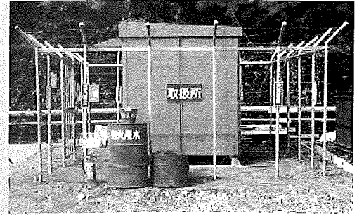
写真-1 取扱所の設置例
