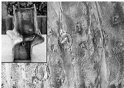
写真-7 上半アーチ部鋼製支保工座屈
