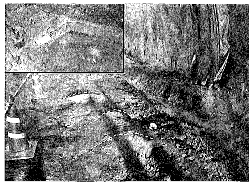
写真-6 上半盤膨れ(ストラット座屈)
