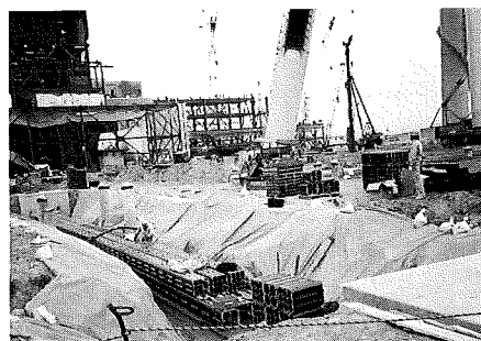
▲ 川越火力発電所 [中部電力(株)]
