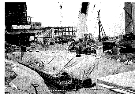
▲ 川越火力発電所 [中部電力(株)]
