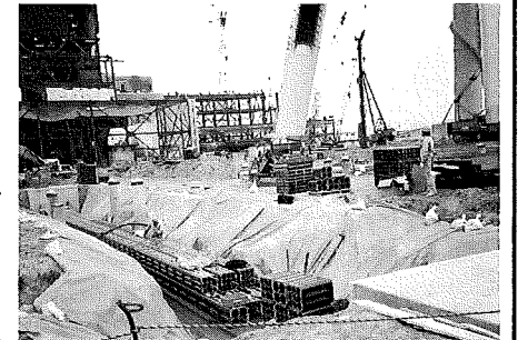
▲ 川越火力発電所 (中部電力株)
