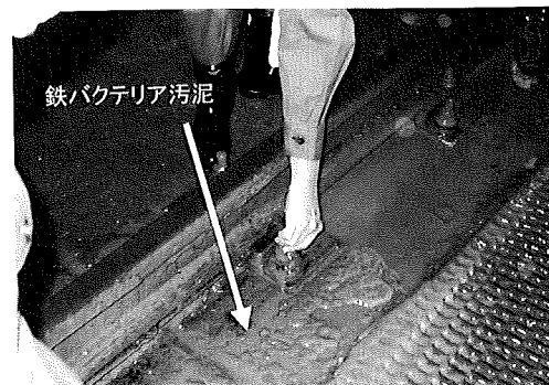
写真-3 排水溝が詰まり湧水が溢れた事例
