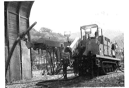
写真-3 試験に使用した吹付け機
