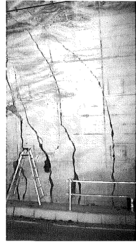
写真-4 木沢トンネルの被害状況(横断方向のひび割れ)
