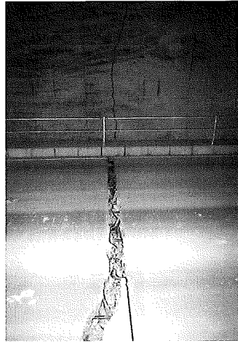
写真-5 木沢トンネルの被害状況(舗装版のひび割れ)
