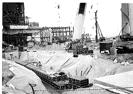
▲ 川越火力発電所 (中部電力株)
