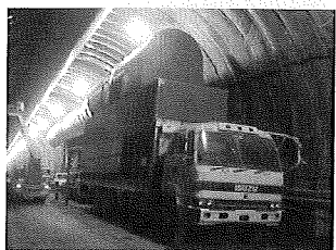
写真-7 集塵機3,000m 3 ④
