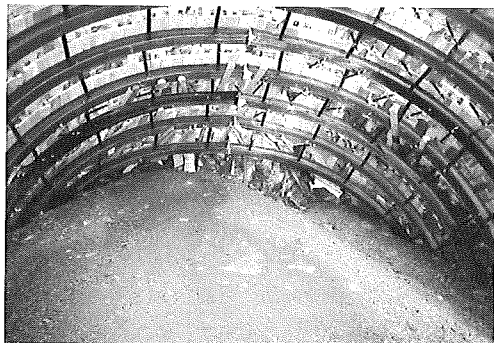
写真-3 切羽崩落状況
