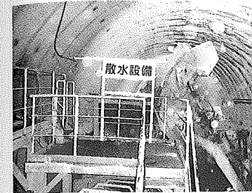
デッキずり積み箇所散水設備
