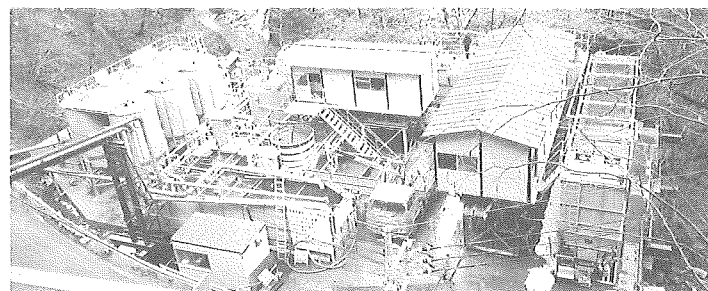
北陸新幹線碓氷峠トンネル(東)濁水処理設備
