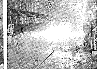
坑内タイヤ洗浄設備
