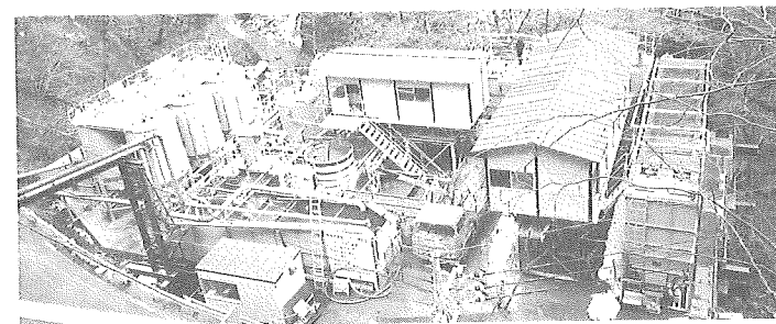
◀北陸新幹線碓氷峠トンネル(東)濁水処理設備
