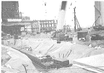
▲ 川越火力発電所 (中部電力株)
