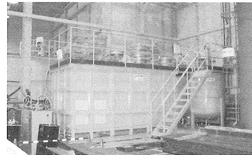
写真-2 起泡材作成設備
