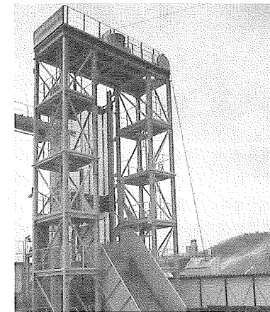
写真-1 スキップ地上構設備
