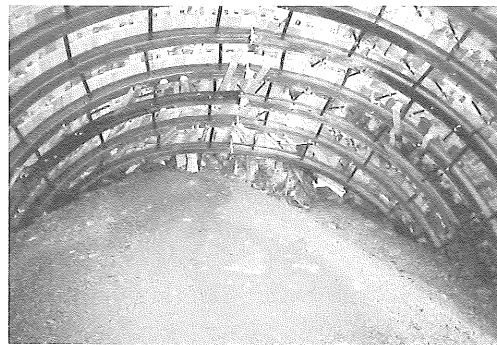
写真-3 切羽崩落状況
