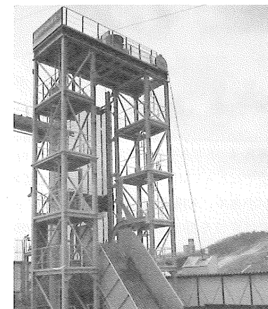
写真-1 スキップ地上機設備
