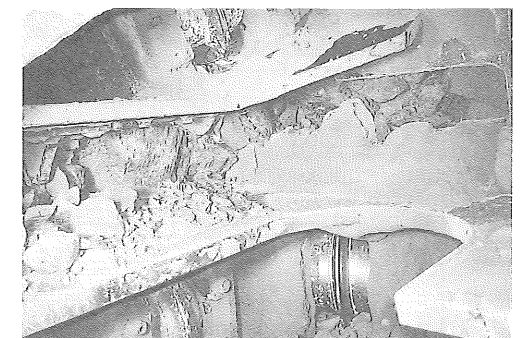
写真-4 切羽鏡の崩壊状況(第四紀凝灰質火山岩)
