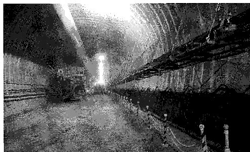
写真-11 本坑連続ベルコン設置状況
