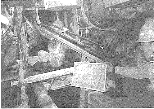
写真-9 カッタヘッドチャンバ入口部の空圧式ドリフタ配置
