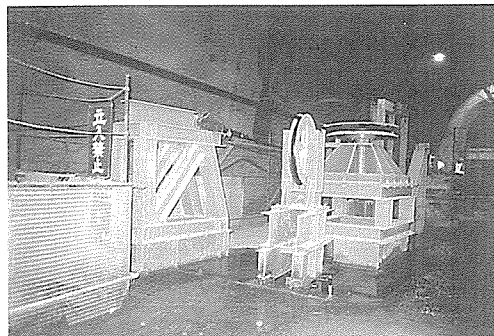
写真-10 斜坑上部インクライン設備
