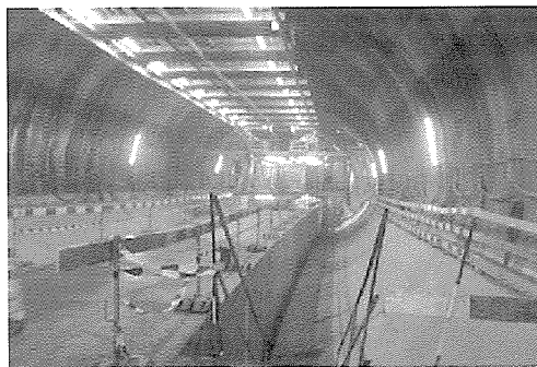
写真-12 トンネル坑内TBEバルコン状況
