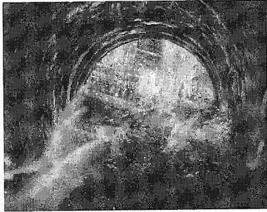
写真-11 60t/min以上の湧水状況。この状況でもガントリ足場で水を避けながら掘進が続けられた。
