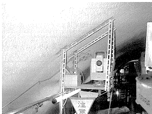
写真-2 トータルステーション設置状況
