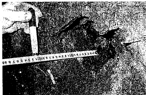
写真-2 プレートのめり込み状況
