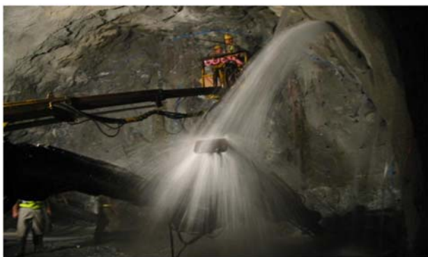
図-8 斜坑における出水(2)
