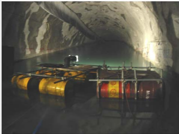
図-7 斜坑における出水(1)
